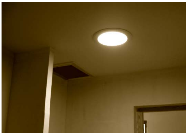
TUBE À LUMIÈRE VU DE L'INTÉRIEUR DE LA MAISON (Photo : SOLENER)
