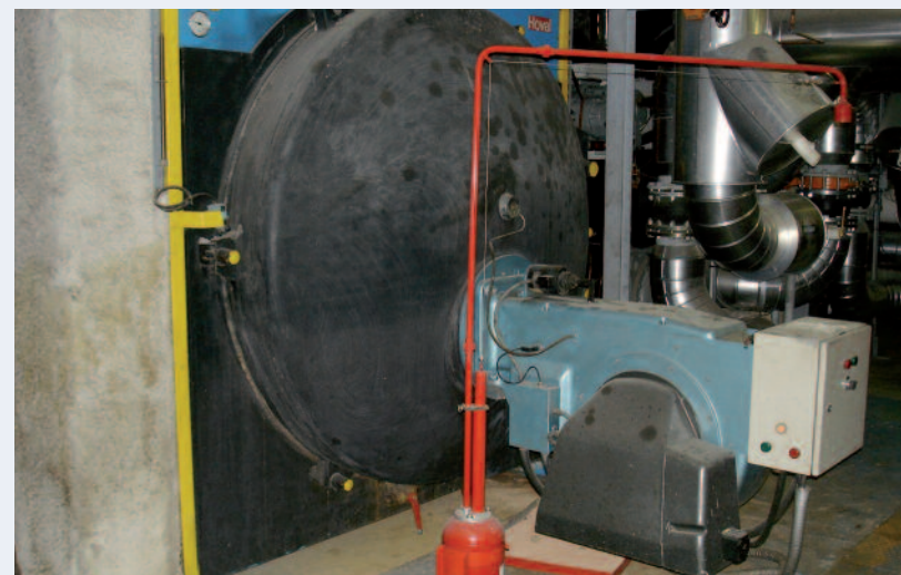
Figure 22 : Vue d'une des deux chaudières fioul
