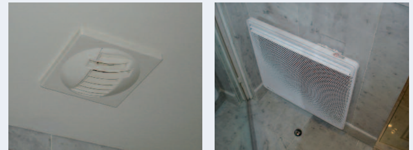
Figure 32 : Vues des équipements des salles de bain : VMC et rayonnant électrique
