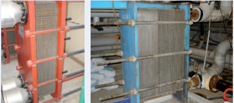
Figure 23 : Vues des échangeurs des circuits eau chaude et eau glacée de la sous-station
