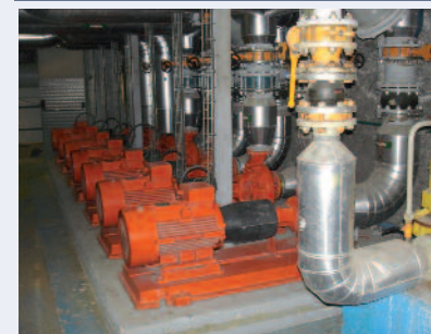
Figure 21 : Vue des pompes réseau primaires
