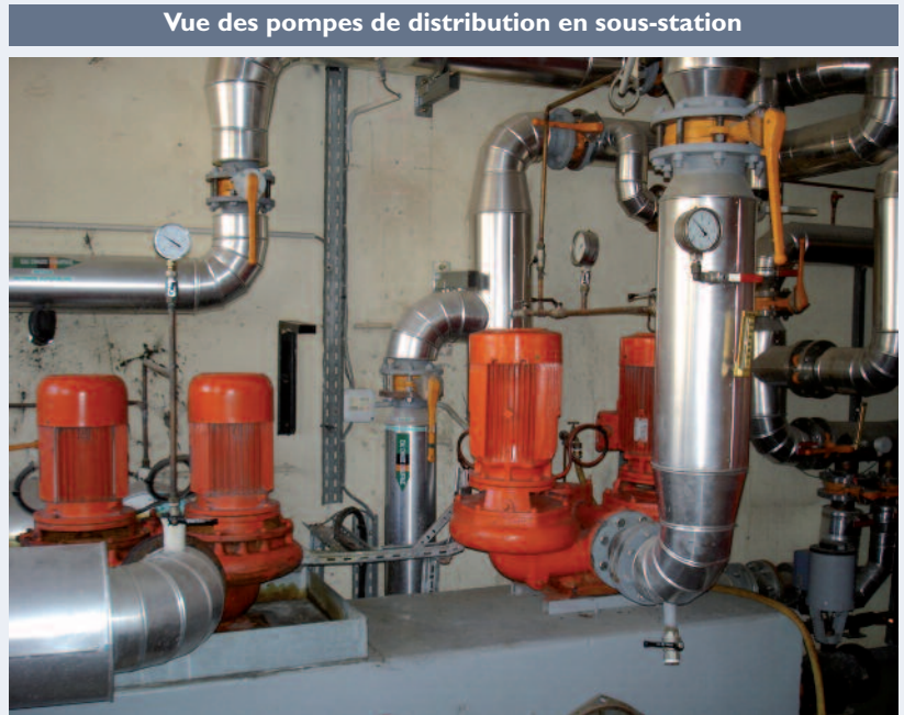
Figure 24 : Vue des pompes de distribution en sous-station
