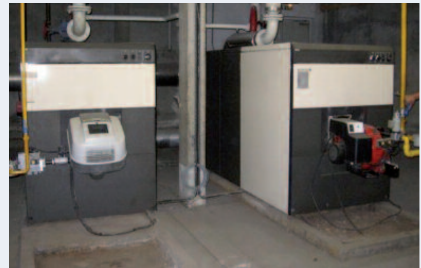
Figure 12 : Les deux chaudières et leurs brûleurs ; l'alimentation gaz (en jaune)
