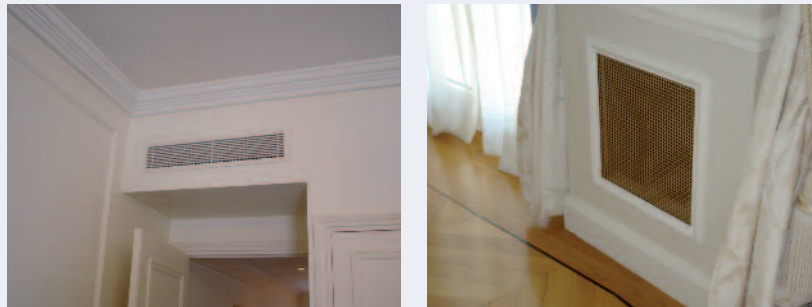
Figure 30 : Vues d'une grille de soufflage et d'une grille de reprise
