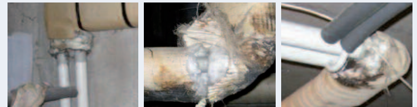
Figure 15 : Exemples de calorifuges non satisfaisants
