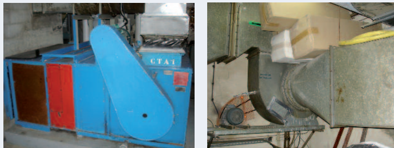
Figure 26 : Vue de la CTA n° 1 (soufflage bar Américain) et de l'extracteur associé
