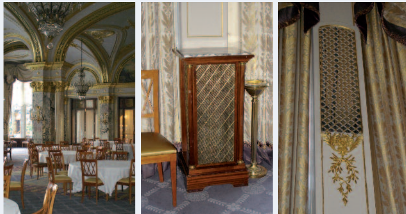
Figure 27 : Vues de la salle Empire et des dispositifs de soufflage/reprise d'air (côté zone vitrée)
